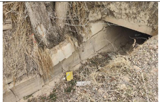
光联村渠道损坏
